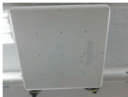
装置全体(上)と天井部にセットされた RFIDリーダー/アンテナ(下)
