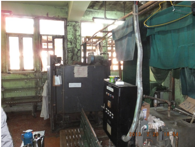
古い滅菌装置が1台。写真のような状況。
