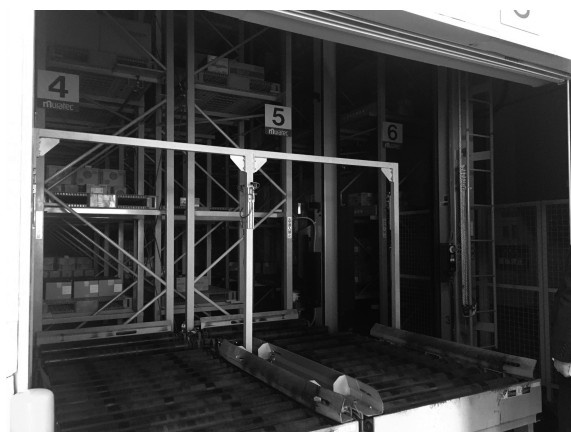
写真③ 自動倉庫の様子
